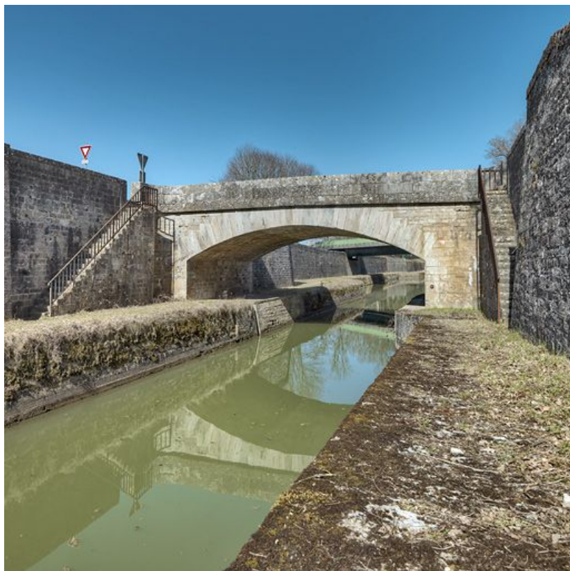
Le pont en pierre de l'amont, avec ses deux escaliers d'accès à la banquette de halage de la tranchée. Derrière le pont plus récent. 21, Saint-Thibault, lieudit : bief 13 du versant Yonne
