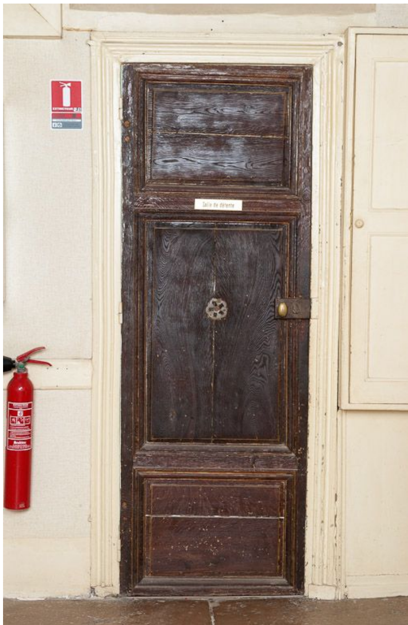
Corps de bâtiment principal : porte de l'extrémité ouest du couloir transversal. 21, Moutiers-Saint-Jean, 8 place de l' Hôpital
