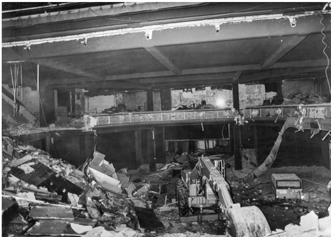
[Destruction du balcon de la salle d'origine du Gaumont]. S.d. [1974].
