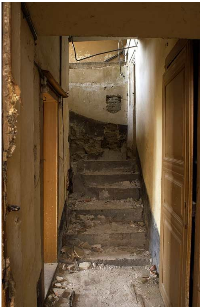
Ancien hôtel du gouverneur : passage donnant accès au laboratoire (porte à gauche) et à un escalier en ruine. 21, Semur-en-Auxois, 7 rue de l' Hôpital
