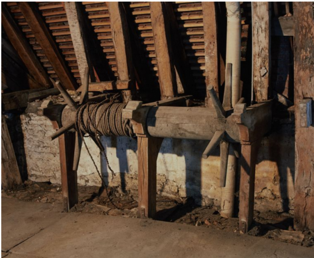
Salle de spectacle en 1996 : mécanisme du lustre (dans le comble). Ce mécanisme a été supprimé après 1996. 21, Châtillon-sur-Seine place de la Résistance
