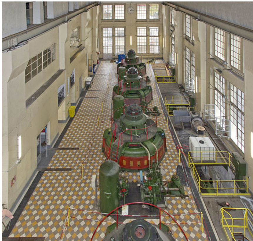
Centrale : vue plongeante sur la salle des machines (groupes n° 2 à 4).
