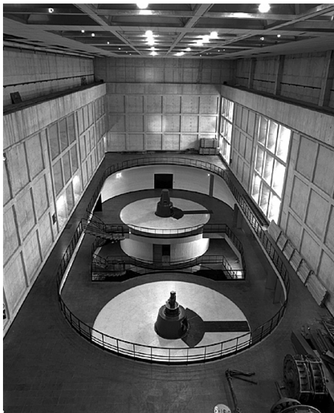
Intérieur de la centrale.
