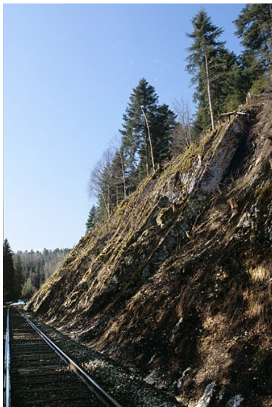
La voie sur la commune de La Chaux-du-Dombief : paroi rocheuse à proximité du tunnel du Morillon. Entre les PK 028.000 et 029.000.
