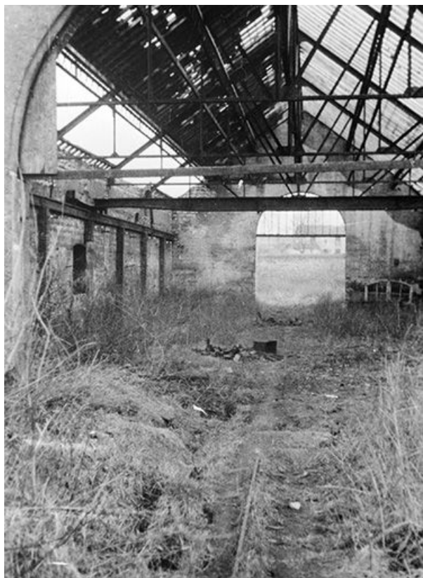
L'usine en ruines : intérieur d'un atelier de fabrication.
