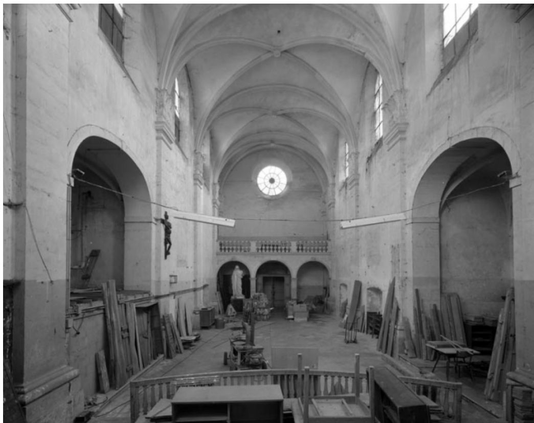
Chapelle : intérieur, nef depuis le chœur avec chapelles latérales. 70, Gray Grande Rue 73
