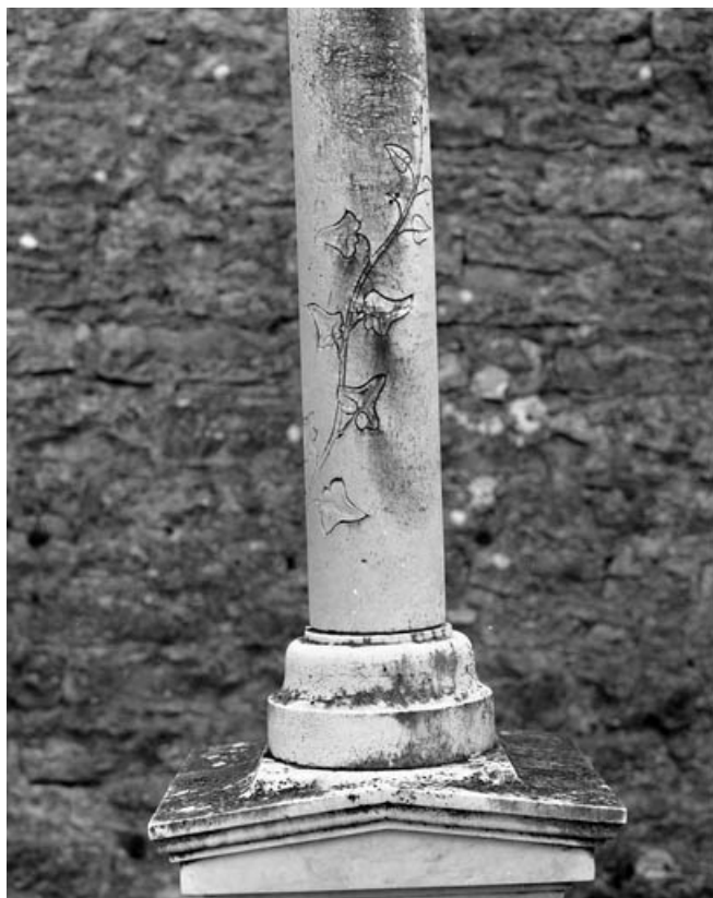
Détail de la base de la colonne brisée.
