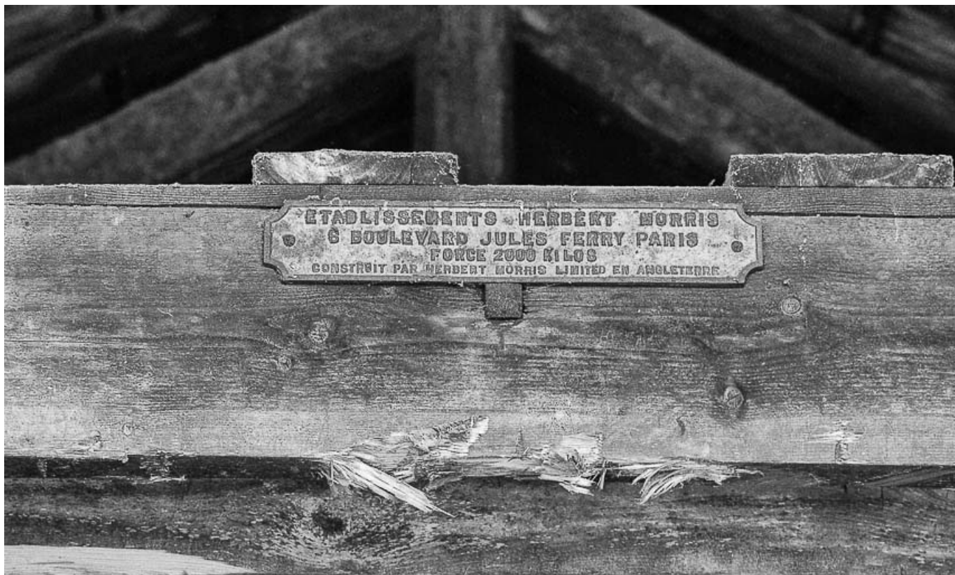
Extrait de la charpente du haut fourneau en 1979. Détail d'une plaque signalétique.
