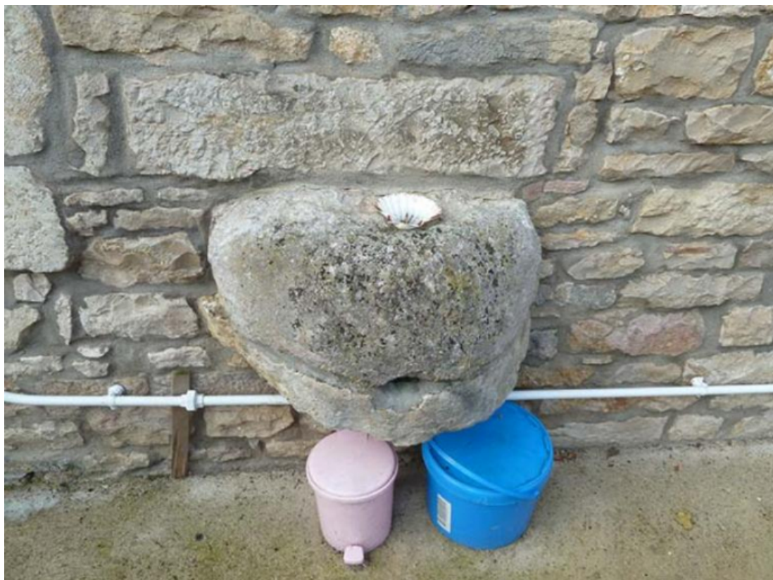
"Goulotte" d'évacuation de l'évier intérieur
