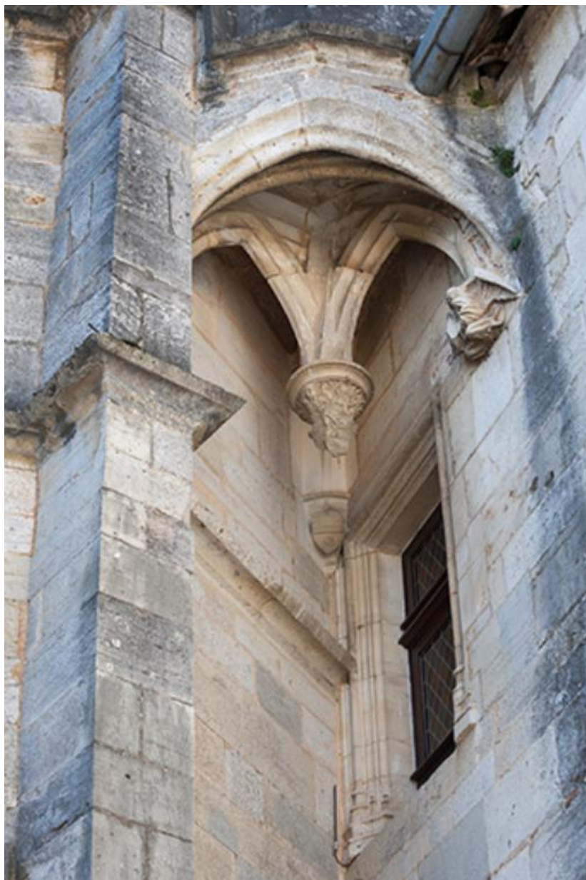
Clé de voûte située sous la tour accolée à la tour d'escalier 70, Gy rue du Château
