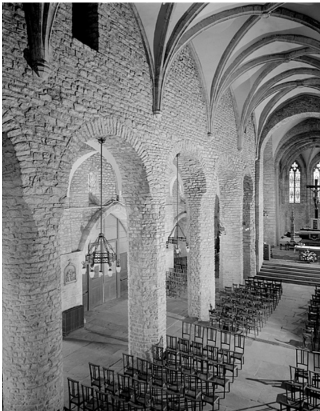
Eglise Saint-Désiré. Vaisseau central et vaisseau latéral nord, vue générale. 39, Lons-le-Saunier, 1 rue de la Préfecture
