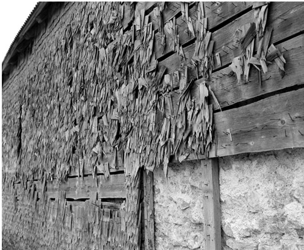
Façade latérale droite en 1978. Elle est protégée par un essentage de bardeaux cloués. 25, Les Villedieu rue Principale
