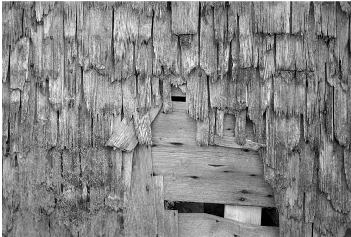
Ferme datée de 1870, située 5 rue de la Grande Fontaine : tavaillons sur le pignon gauche. 25, Chaux-Neuve
